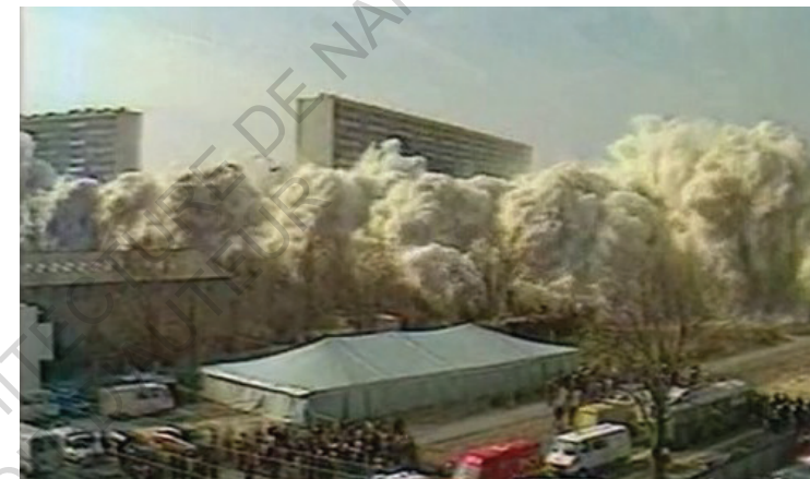
Figure 1 - Implosion de la barre Debussy à la cité des 4000 à la Courneuve en 1986
