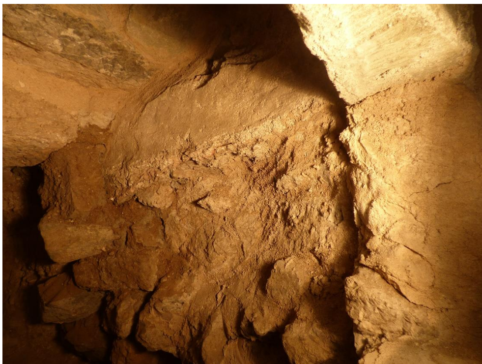
Fig. 58 – Église Saint-Pierre de Lémenc, Chambéry (Savoie), espace à l'arrière de l' oculus , traces d'enduit
