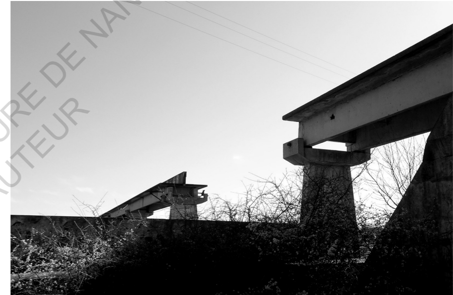
Une traversée compromise, 30 mars 2019.
