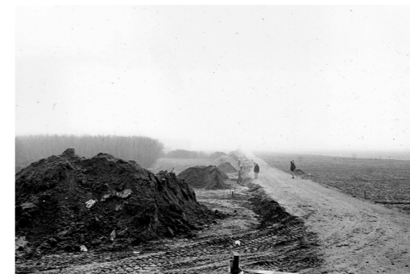
Les dégagements et la voie d'accès nécessaire aux travaux s'étendent dans la Beauce. © Association AJB
