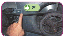
Courroie en bon état et correctement tendue : OK
