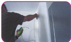
Mesure de la pression derrière une bouche d'extraction à l'aide d'un manomètre
