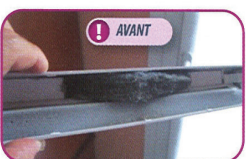
Entrée d'air obturée par un occupant avec de la mousse !
