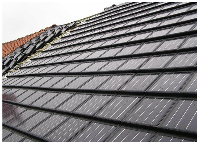
Figure 10 : Photo représentant un toit en cours de couverture avec des tuiles NeoSolPan
