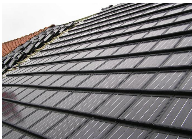
Figure 10 : Photo représentant un toit en cours de couverture avec des tuiles NeoSolPan
