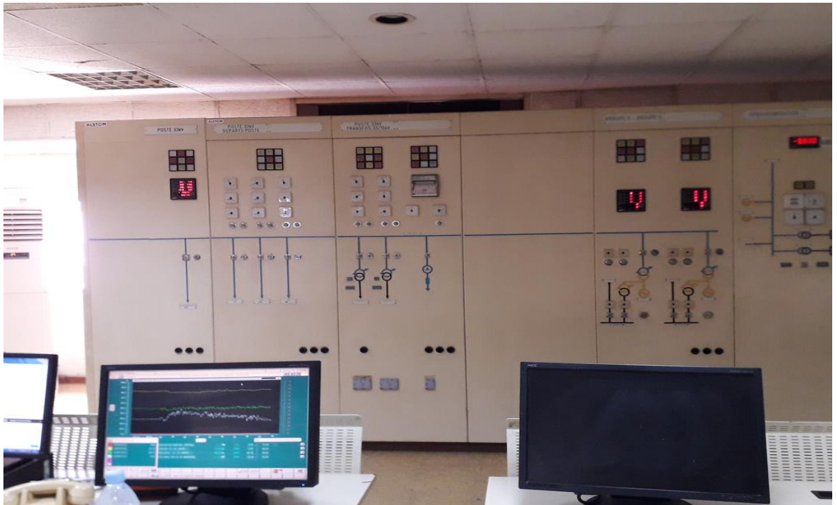
Figure 20 : Image de la salle de commande centre dispatching
