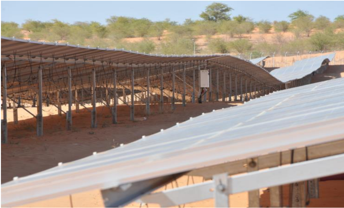
Figure 13 : photo des installations de la centrale solaire 50 MW
