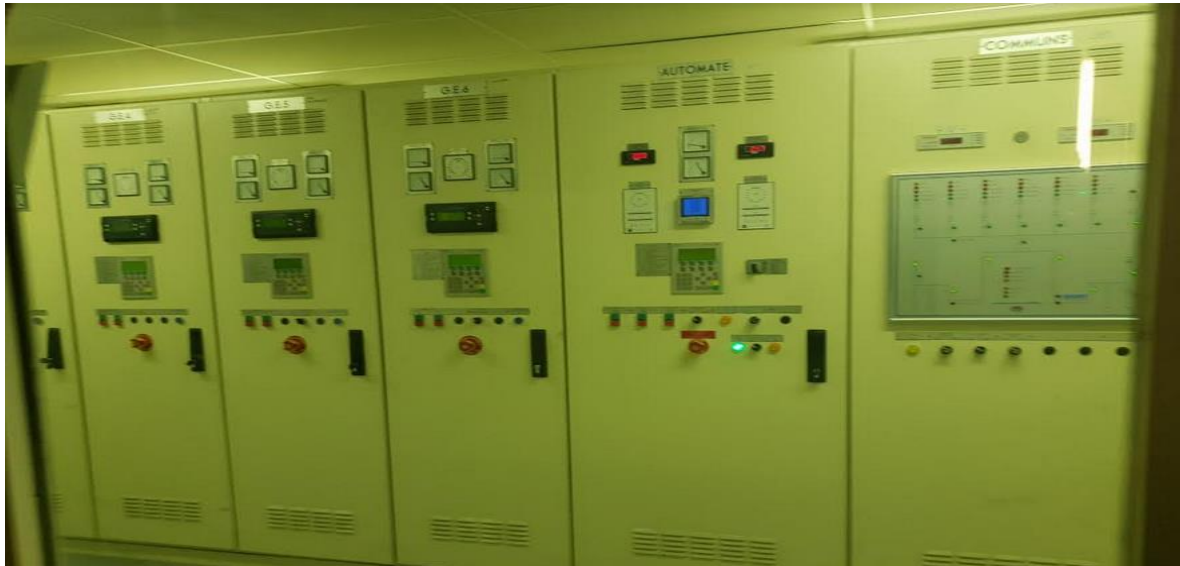
Figure II.4 : cellules de commande des GE.
