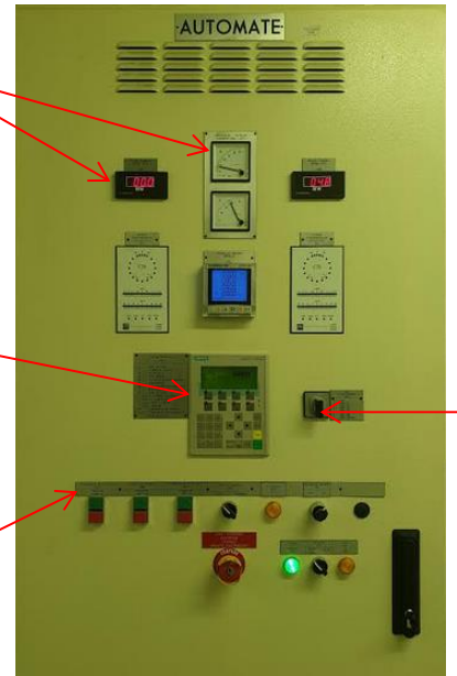
Figure II.6 : armoire Automate de contrôle.
