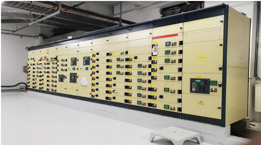
Figure III.3 : tableau général basse tension (TGBT).
