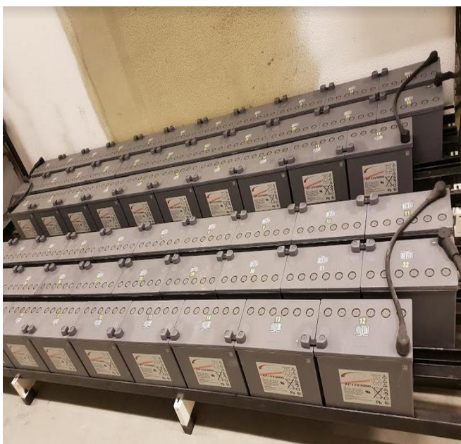
Figure III.4 : parcs de batterie.
