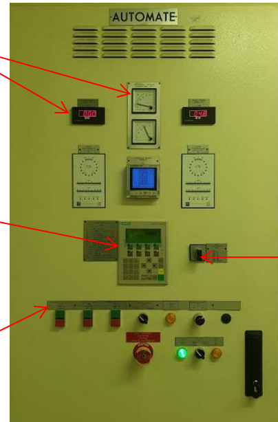
Figure II.6 : armoire Automate de contrôle.
