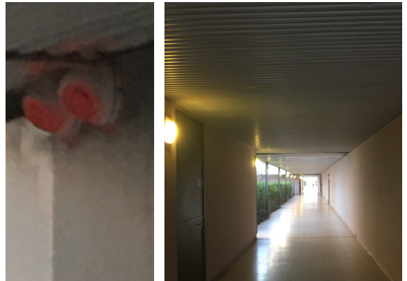
Galerie sombre et caméras vandalisées
