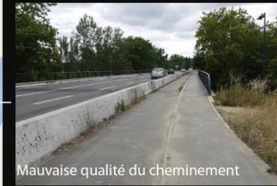
Mauvaise qualité du cheminement
