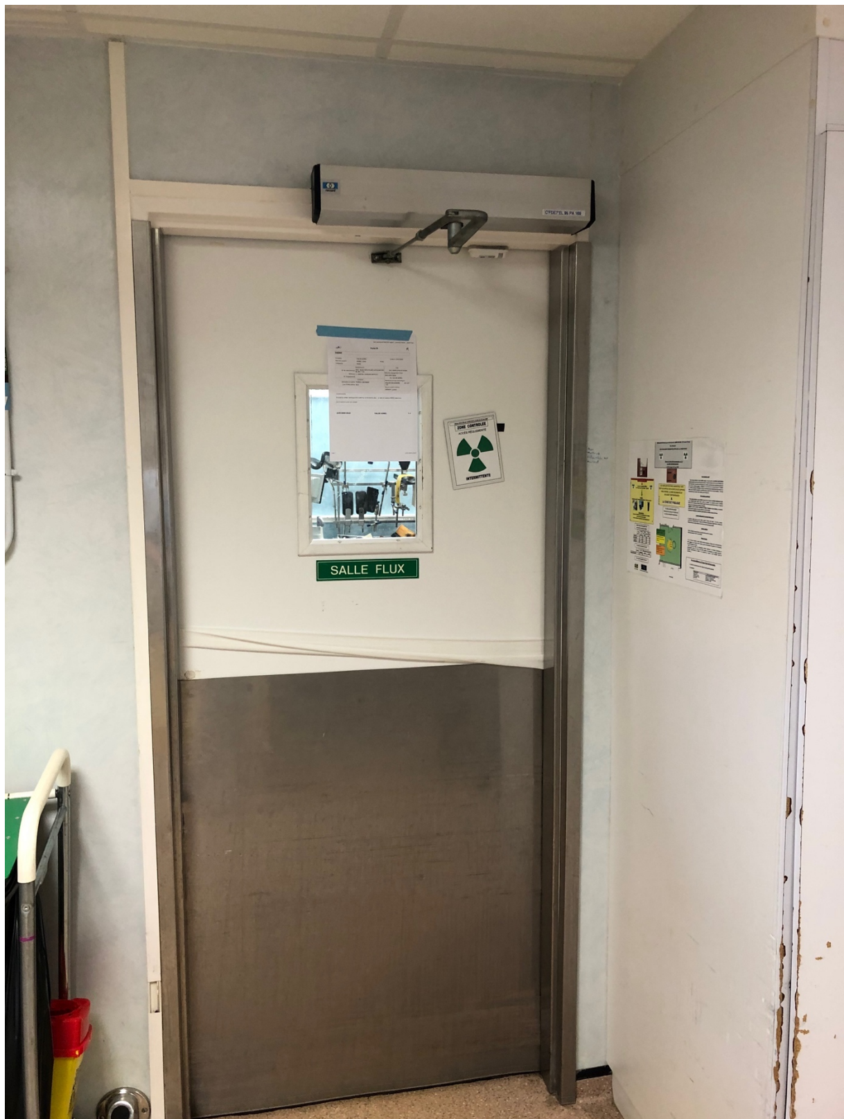
Figure 35 : information de radioprotection en entrant dans l'une des salles du bloc orthopédique
