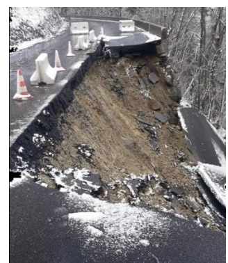
Photographie 3 : Glissement de terrain de Ballandaz le 4 janvier 2020, emportant la route entre Bozel et Pralognan la Vanoise (Photo Letesse, 2020)
