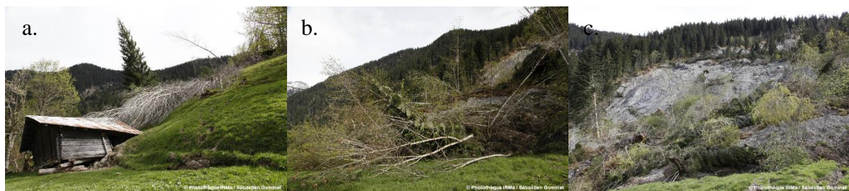
Photographie 2 : Glissement de terrain du Bersend : a. une grange poussée par la terre qui avance ; b. arbres basculés en rive gauche et c. niche d'arrachement (Photos Gominet, IRMa, 2016)
