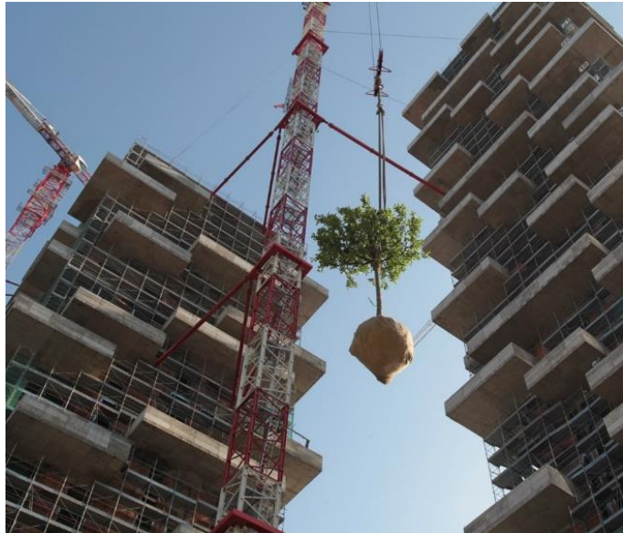
Figure 10 : Photo de l'installation d'un arbre sur le chantier de la Forêt verticale par Boeri à Milan Source : Marco Garofalo
