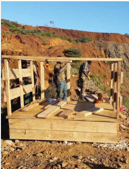
Figure 10 : chantier pour la création d'un point de vue à l'ancienne mine de Tiébaghi par la section MDT, site historique du Nord de la Nouvelle Calédonie – RSMA-NC
