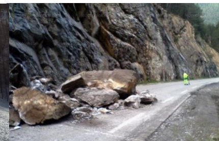
Figure 27 : Chutes de blocs juin 15 (Le dauphiné libéré. 2015)
