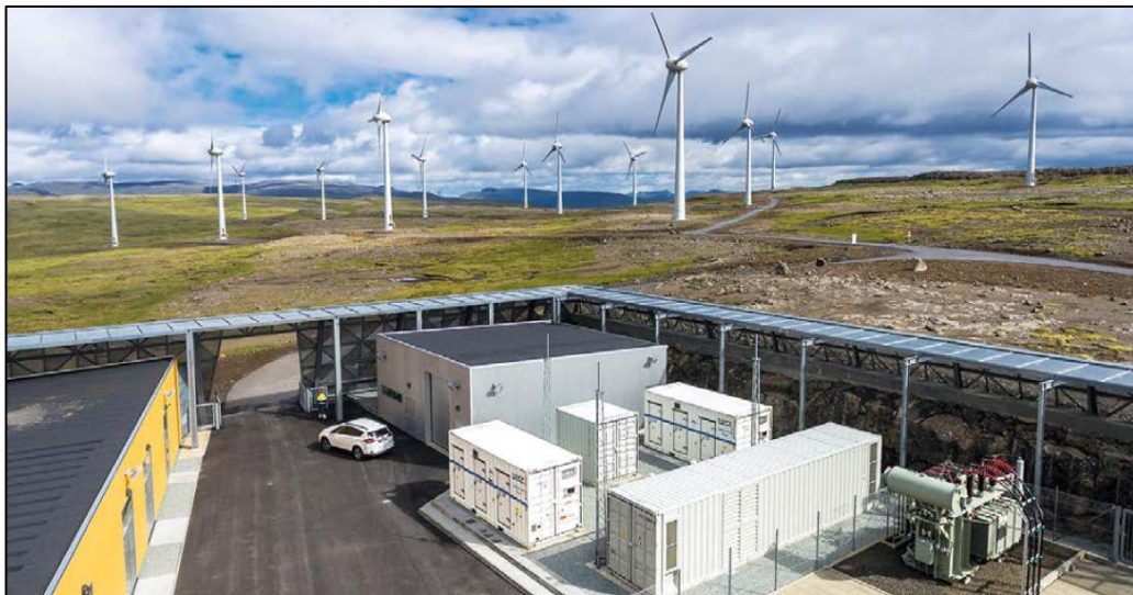
Figure 19 - Usine SALT de batteries et champ d'éoliennes aux îles Féroé 14
