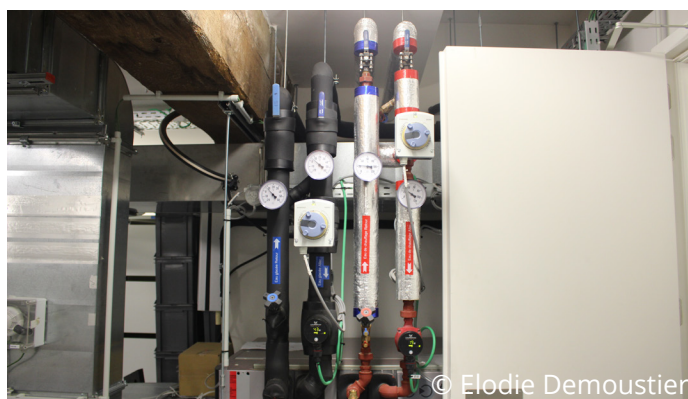
Système de régularisation du climat
