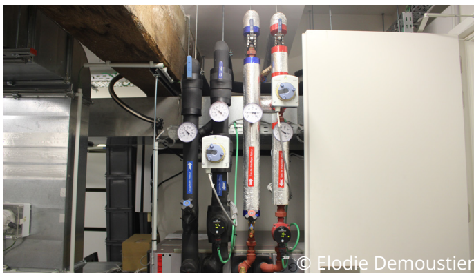
Système de régularisation du climat
