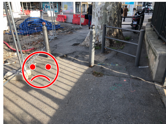
Figure 39 : Sol endommagé et signalisation sans contraste
