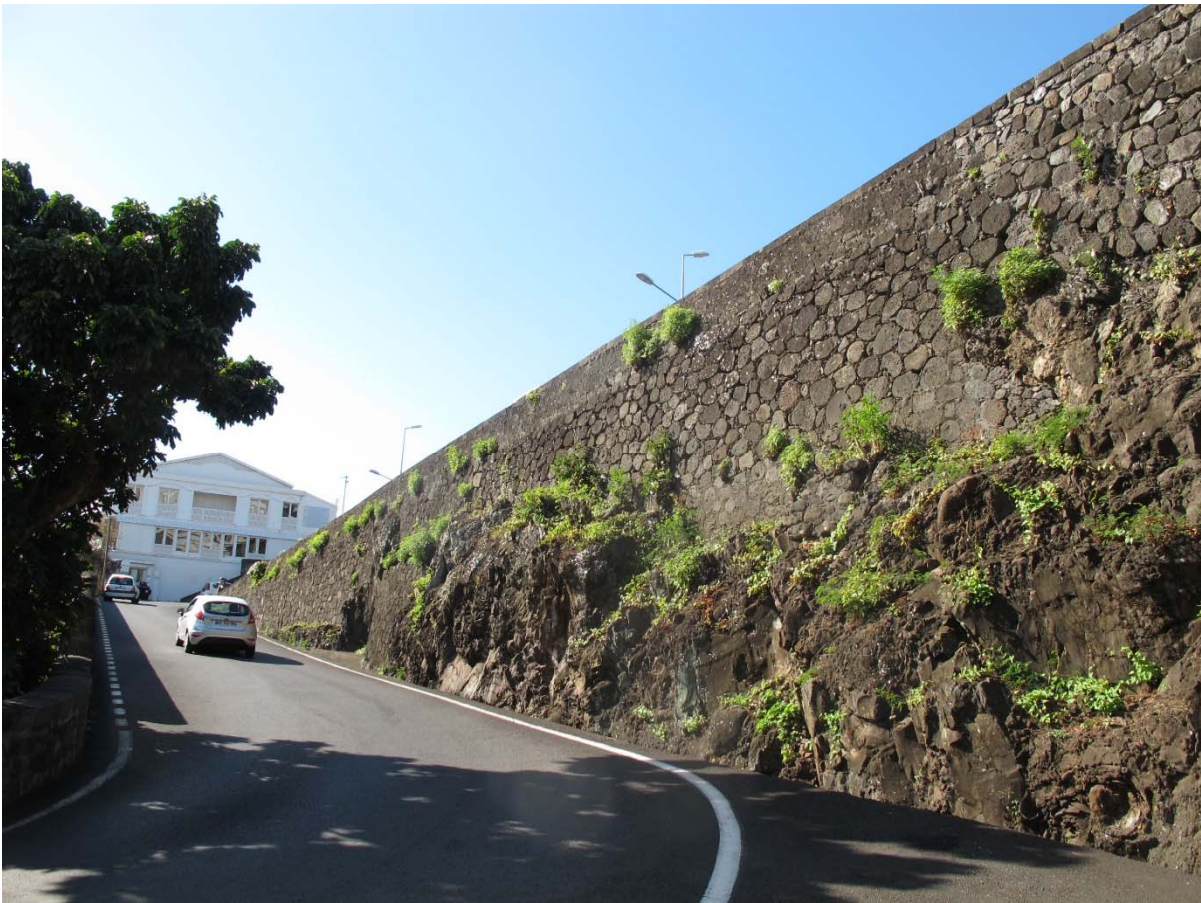
Mur de soutènement en pierres de lave, Bas de la Rivière, Saint-Denis, 2013
