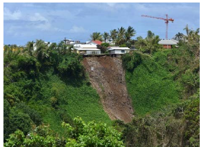
Exemple de vulnérabilité de l'habitat, Sainte-Marie, La Réunion Glissement de terrain suite au passage du cyclone Béjisa, janvier 2014
