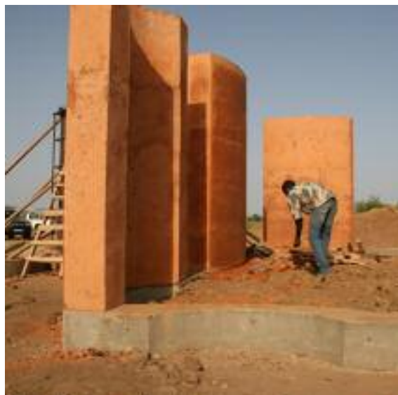
Fig. 288 Vue des murs décoffrés et de soubassement qui suit la forme des murs. (Holcim Foundation, 2014)
