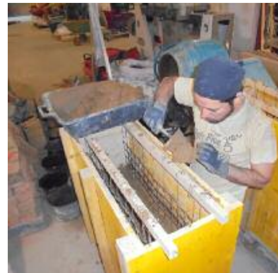
Fig. 225 Fixation des géogrilles aux tasseaux bois et remplissage à la truelle entre les face du coffrage et la géogrille.
