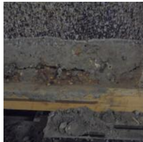
Fig. 237 Fissuration du muret dans l'axe des vis d'ancrage.
