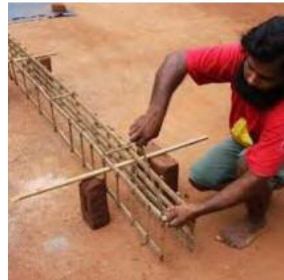
Fig. 139 Armature double, application de résine époxy. (photo : Browne)(Browne, 2013. p.31)
