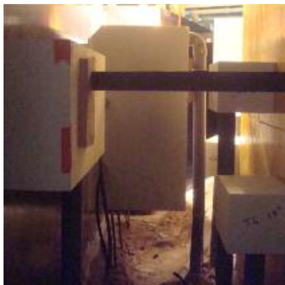
Fig. 277 Vue des niches en polystyrène, avec des tuyaux de ventilation et des installations électriques à l'intérieur d'un autre module.
