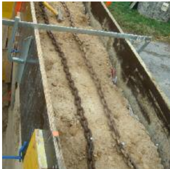
Fig. 266 Vieilles chaînes métalliques clouées à une tête de mur avant le coulage.
