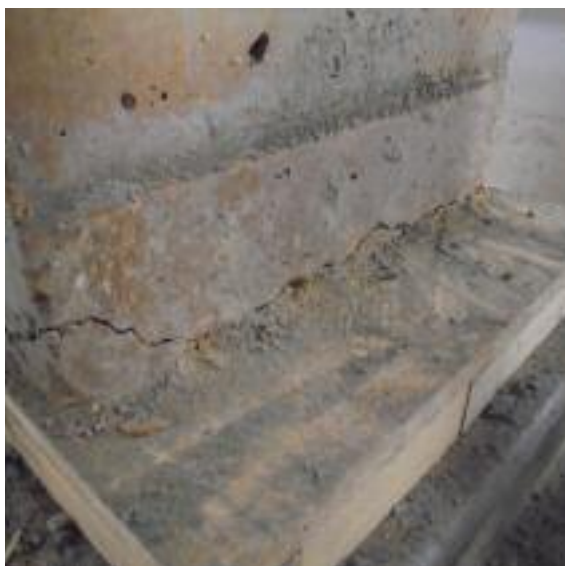
Fig. 238 Fissuration du muret dans l'axe des vis d'ancrage.
