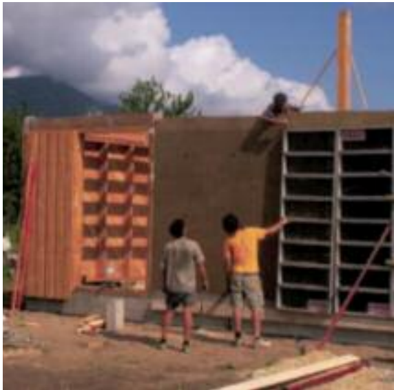
Fig. 37 Décoffrage de mur dans le chantier de Sasse-nage, de l'entreprise Caracol. (photo: Joris)
