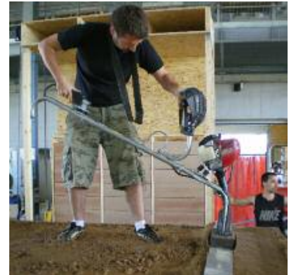
Fig. 42 Utilisation de règle vibrante dans une dalle de terre coulée. (photo: Caracol)
