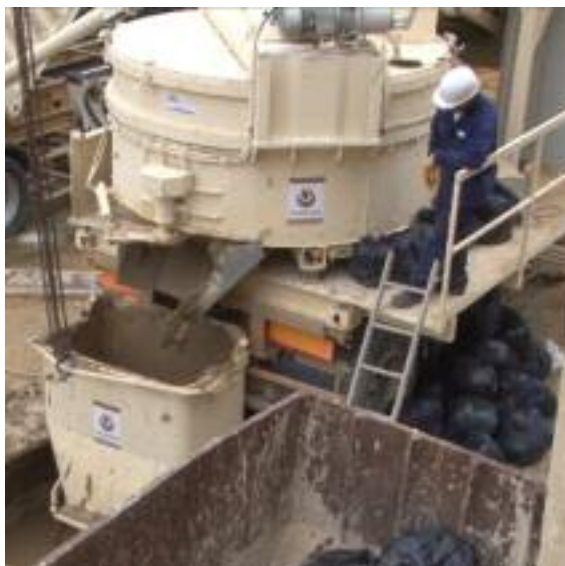
Fig. 306 Centrale de malaxage mobile de l'entreprise Cématerre (Le Moniteur Tv)
