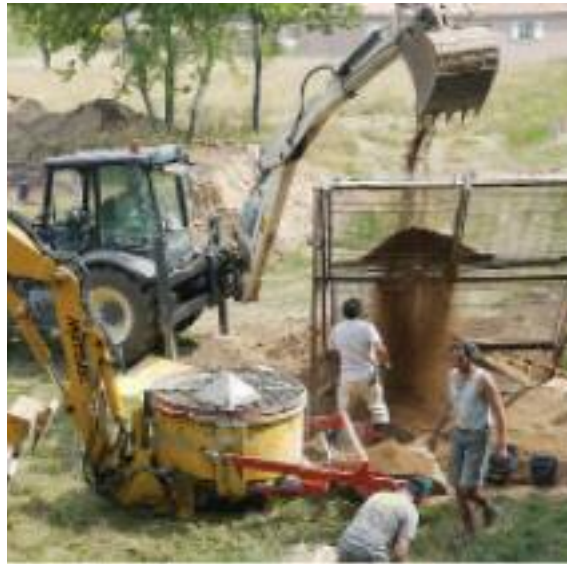
Fig. 29 Malaxage et criblage dans le chantier de à Saint Didier de l'entreprise Caracol. (Moevus, B.A.E., 2013)
