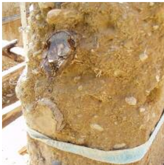
Fig. 54 Inclusions bois dans l'intersection de deux murs en pisé, dans une vieille grange près de Paladru, en Isère, pendant mon stage chez Caracol.
