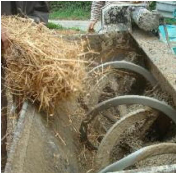
Fig. 28 Ajout de paille dans le mortier au chantier de Paladru, de l'entreprise Caracol.
