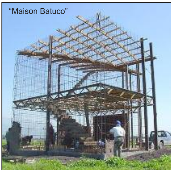
Fig. 201 Structure de la “Maison Batuco” de Marcelo Cortés au Chili, avec l'utilisation de grille métallique. (Cortés, 2012)
