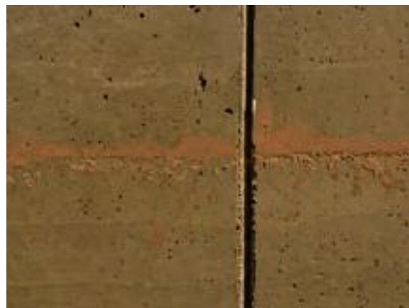
Fig. 262 Joint de dilatation du mur et aspect du mur. (Caracol, 2013)
