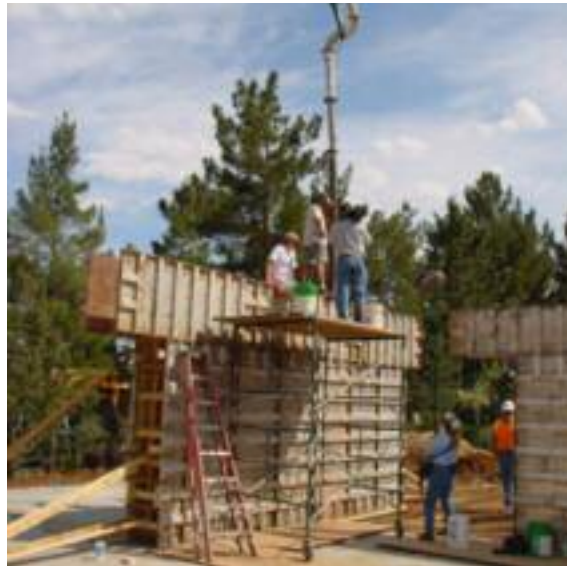
Fig. 38 Pompage de terre coulée dans un chantier de l'architecte Michael Frerking. (Green Home Building)
