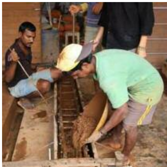
Fig. 140 Coulage de poutre en terre coulée avec armature double. (photo : Browne)(Browne, 2013. p.31)
