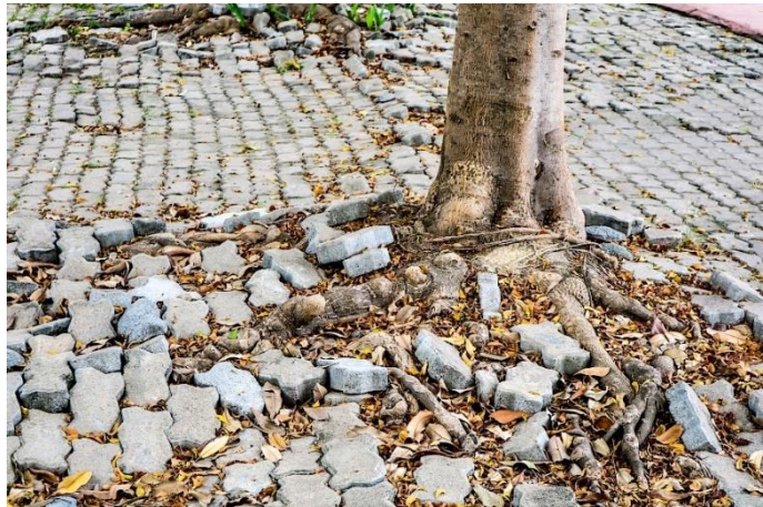
Figure 9 : Racines détruisant un revêtement de pavés béton (source : treebuilders.eu)
