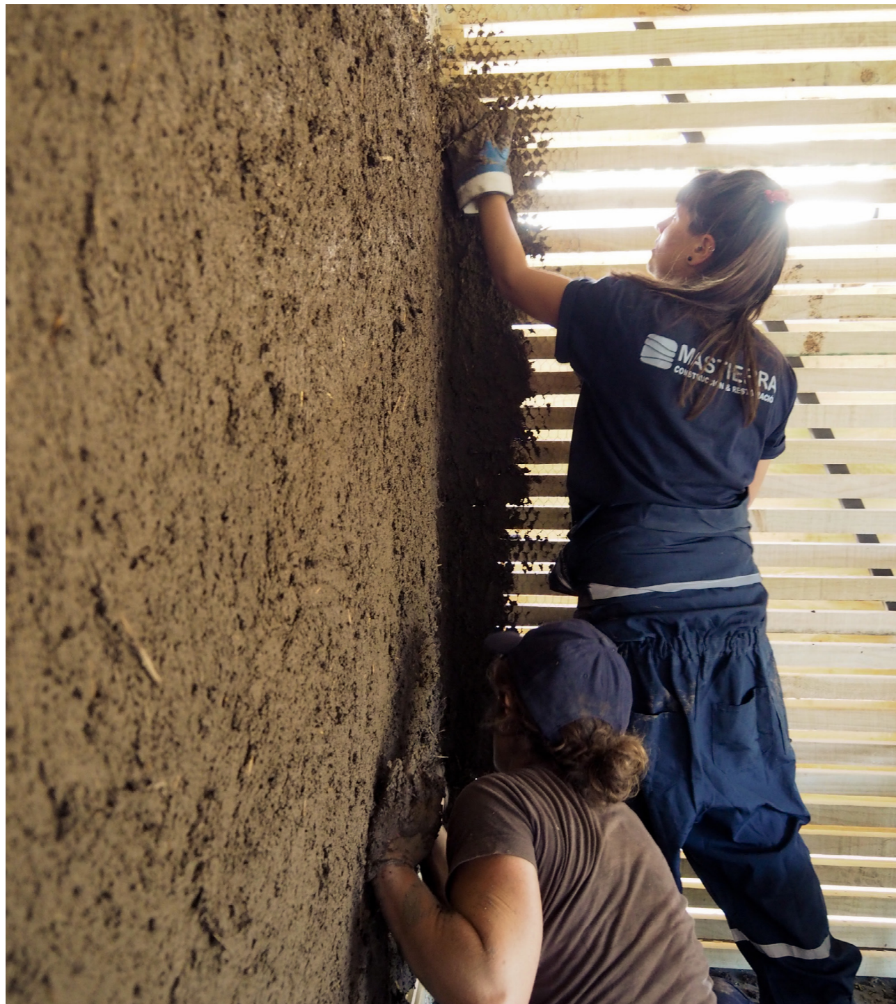
01. Équipe de maçonnes sur chantier, avec Fanny Bouvet et Aude Andry. Stage dans l'entreprise Mas tierra- Construcción y restauración (responsable Arq, Solange Miranda Coletti), Chili, novembre 2019
