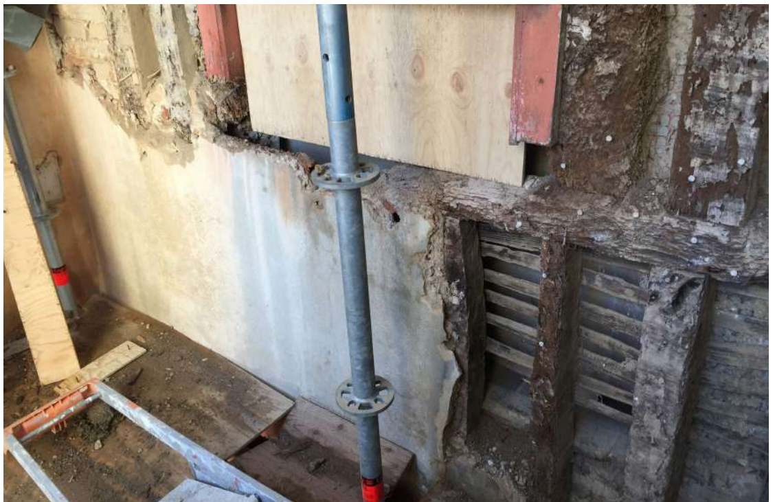
pourrissement du bois sous l'enduit en ciment, 20 place des Lices
