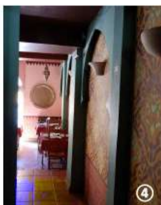
Vue (au RdC) sur les poteaux encoffrés, contre le mur du n°22
