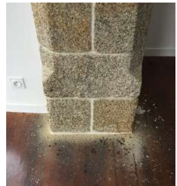
vue du château et des pathologies du granit
