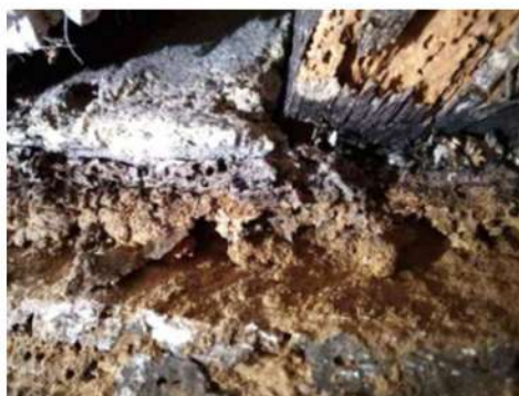
Présence de grosse vrillette Plancher haut du Lot n°116 (R+3 à gauche)
