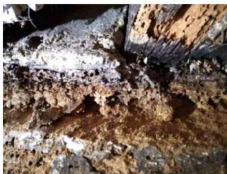
Présence de grosse vrillette Plancher haut du Lot n°116 (R+3 à gauche)
