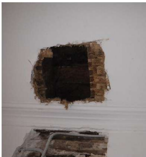
Sondages réalisés en 2001 sur les planchers haut et bas et sur mur de refend en pan de bois – R+3 lot 36
