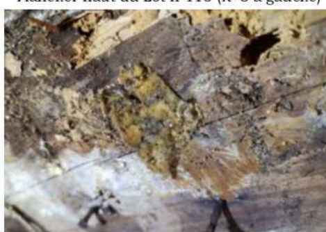
Présence de polypore et de pourriture fibreuse Plancher haut Lot n°118 (R+4 à gauche)
