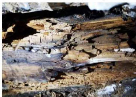
Présence de grosse vrillette Plancher haut du Lot n°114 (R+2 à gauche)
