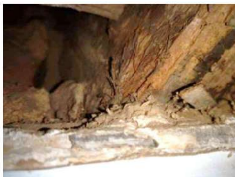
Pourriture cubique Plancher haut Lot n°118 (R+4 à gauche)
