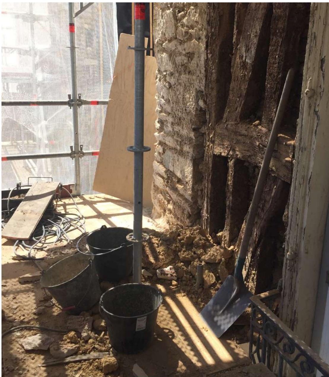
dégradage des remplis, 20 place des Lices
