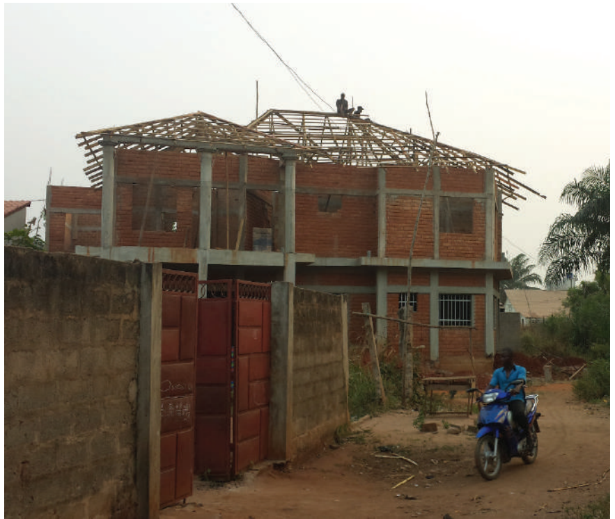
Images du chantier de la maison de Monsieur Ben © Steve Kotey Nicoué
