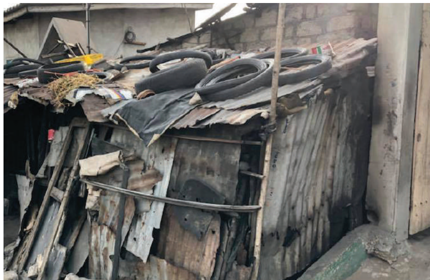
◀ Habitat auto-construit photographié dans une rue d'Akpakpa Dodomey Enagnon à Cotonou le 14 avril 2018
