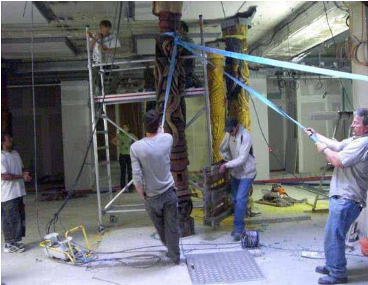
Levée des poteaux qui sont ensuite scellés à la Maison de la Nouvelle-Calédonie. Source : MNC
