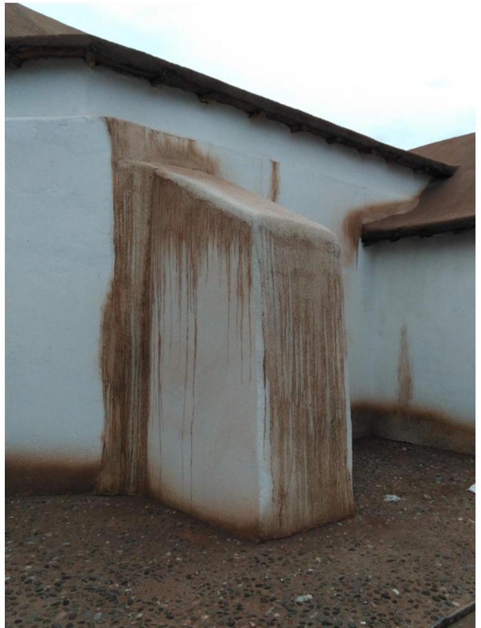
Effet des pluies à la fin du chantier.
