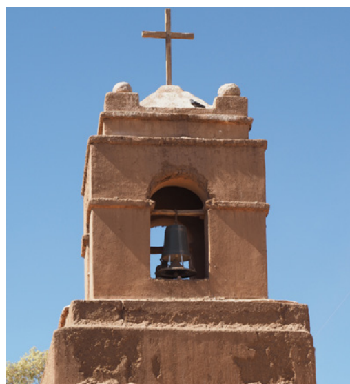
Le campanario (clocher) très détérioré, beaucoup de perte de matériel.
