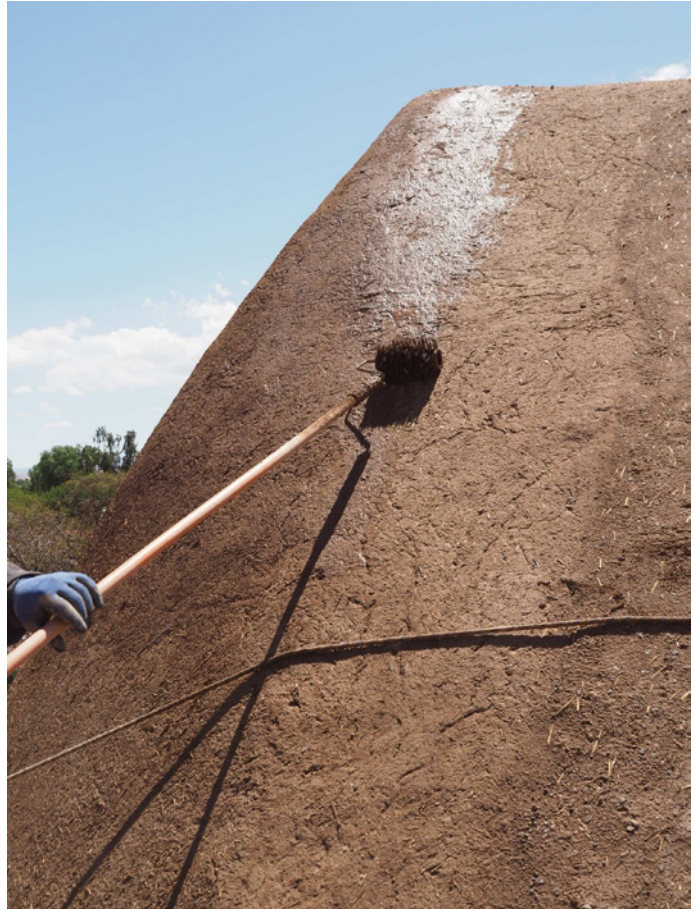
Dernière couche sur le toit, mélange de terre et de gel végétal.
