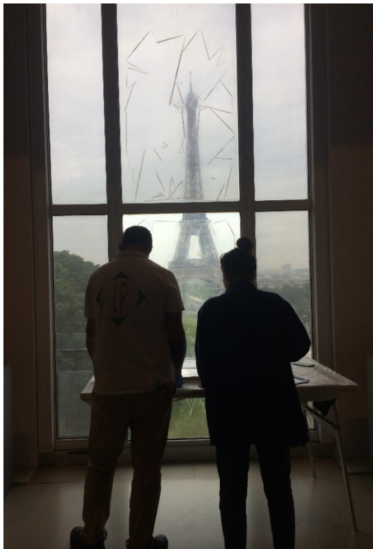
Figure 17. Constat d'état avec vue sur la Tour Eiffel
