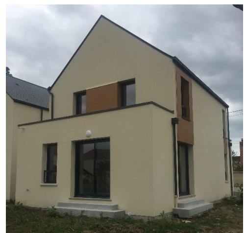
Figure 24 :ZAC de la Cerisaille à Saint Jean le Blanc, Pauline DEVAUX, toit-terrasse, marche d'accès
