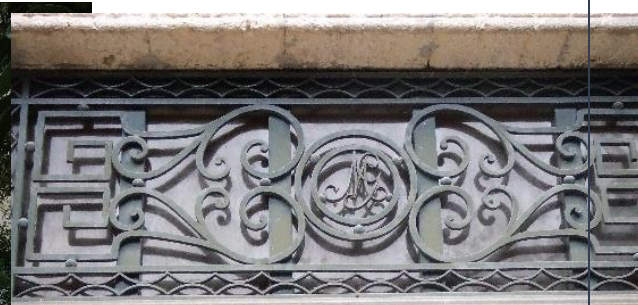
Grille au-dessus de la porte d'entrée de la maison avec les initiales GM
