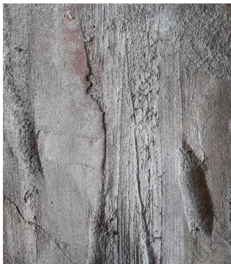
[fig.16] Échantillon de matière pour les parois du puits de la gare de Vitry © Louise Cousseau, BAP!
