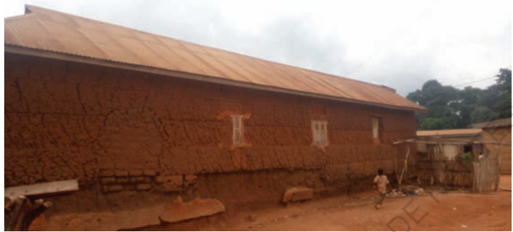
Habitat mixte : mur en banco et toit en tôle zinc aluminium Source: Photo Eric Adjoumani
