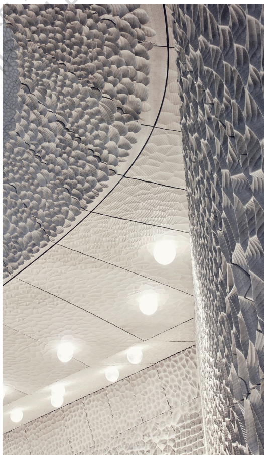
Traitement acoustique des parois de l'auditorium
