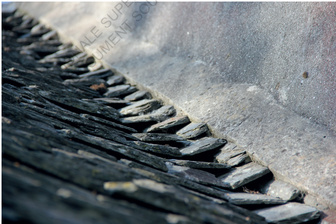
v Détail du toit en tuile de la chaumière, Kervoëlic, le 26 Avril 2020
