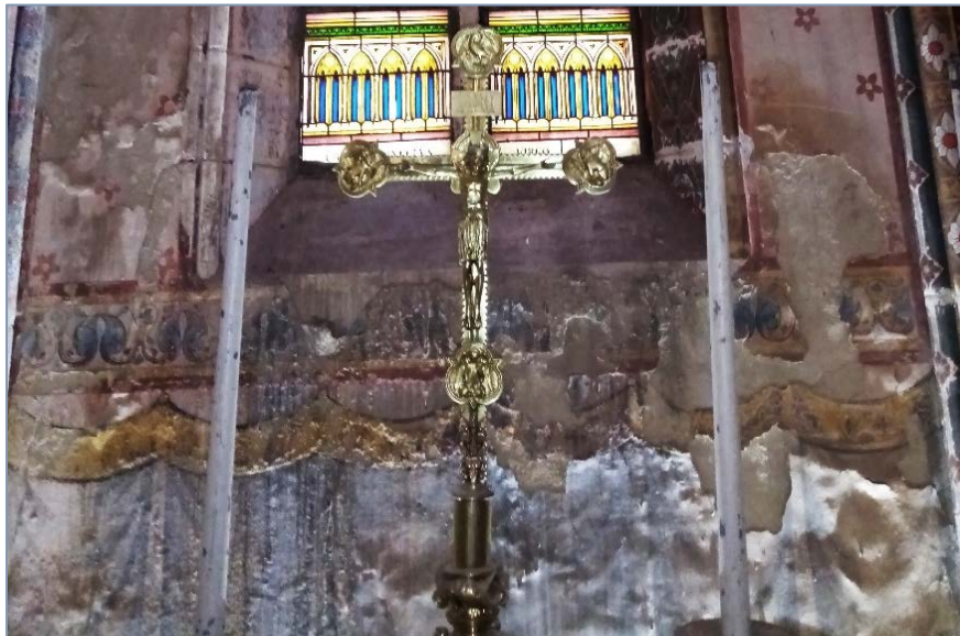
Figure 55 : Des travaux à prévoir dans la chapelle : décollements de la couche picturale dus à l'humidité.
