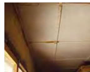
problème d'étanchéité du toit en tôle
