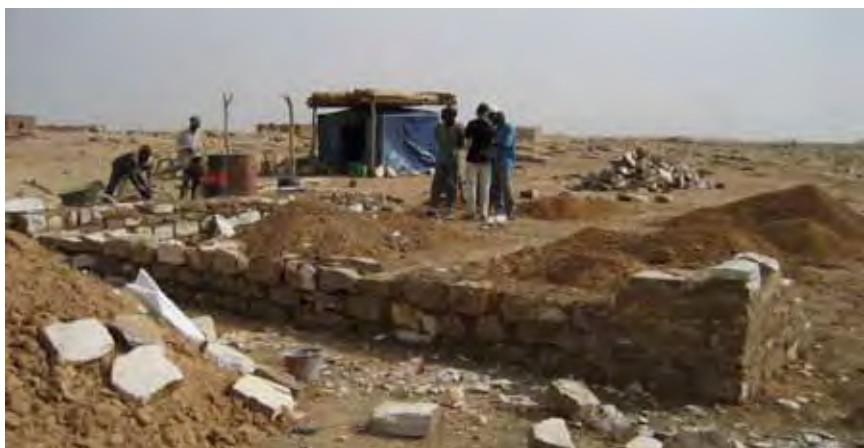
on commence par les angles pour que le soubassement soit de niveau
