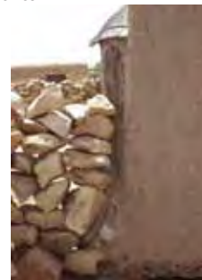
"joints de dilatation" entre clôture et grenier
