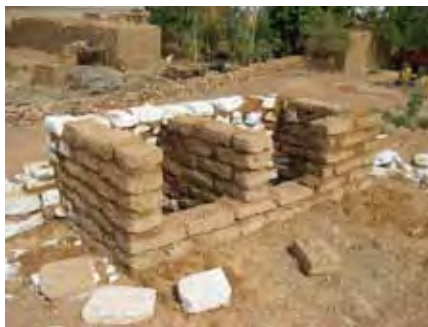
cheminées de ventilation
