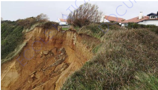
Figure 3, Photographie éboulement, mouvement de terrain le 10/12/20 sur la commune de Bidart.
