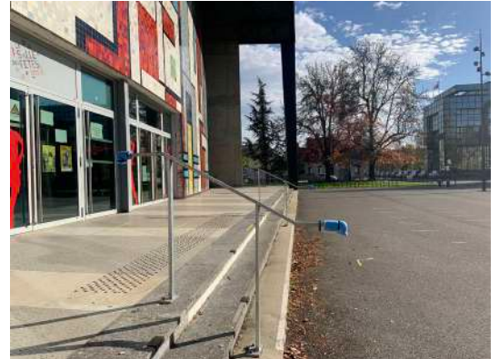
Accès PMR non systématique.
