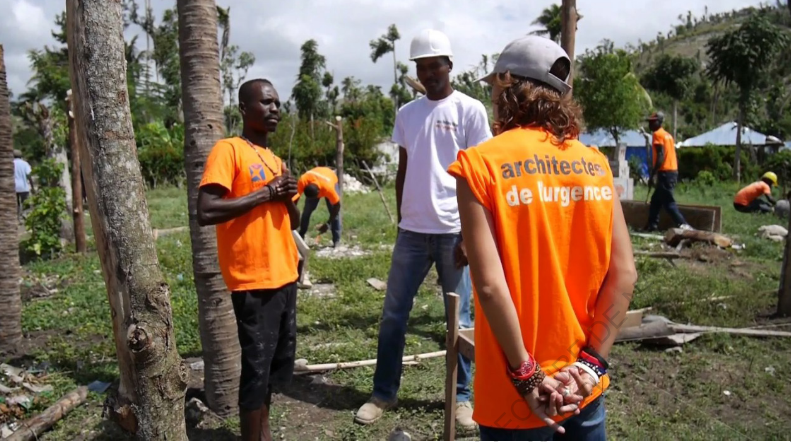
UN CONTREMAÎTRE ET UN ARCHITECTE ÉCHANGENT QUANT À LA PROCÉDURE À SUIVRE ARCHITECTES DE L'URGENCE
