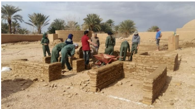
Fig. 50 : fabriquer les adobes et préparation des murs pour construction des voûtes en adobe. (©M. MAHDIEH,2018)
