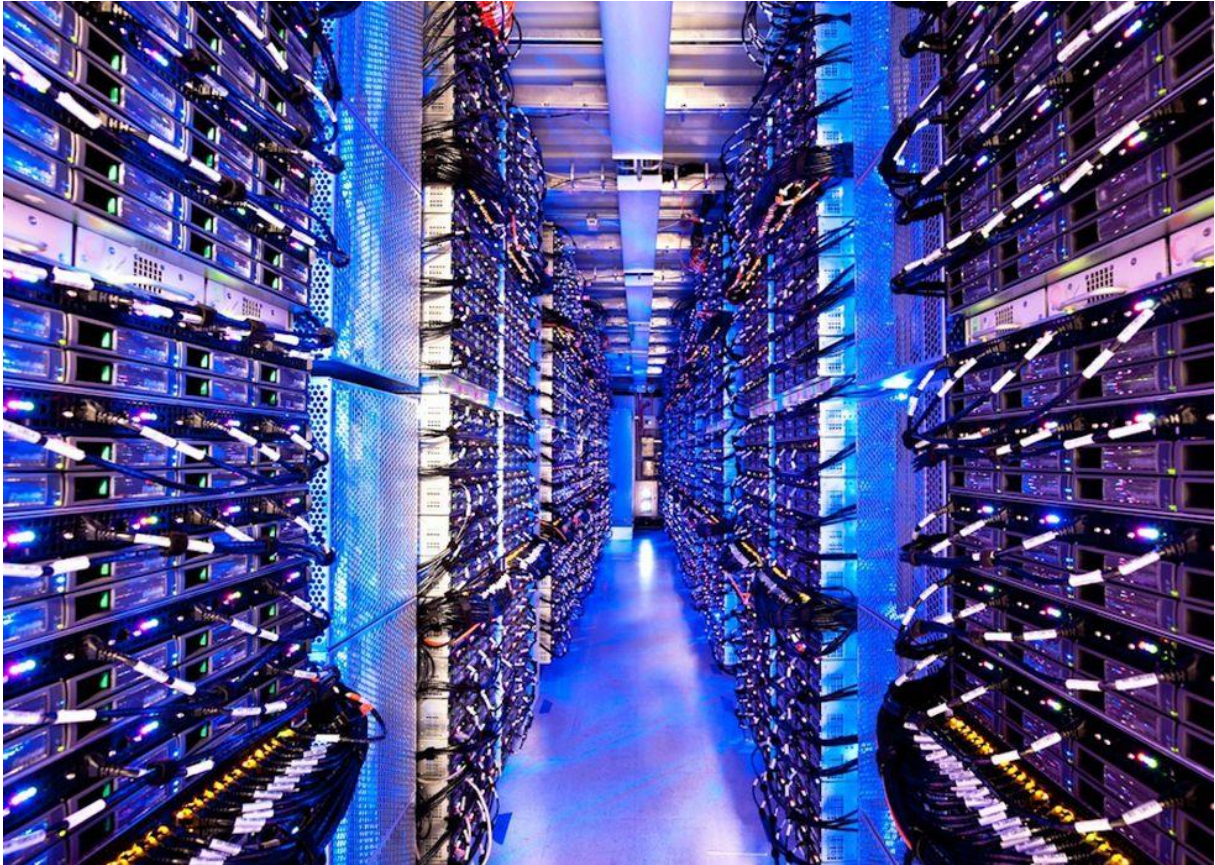
Figure 15: Intérieur d'un data center de Microsoft dans la région de Chicago © Microsoft
