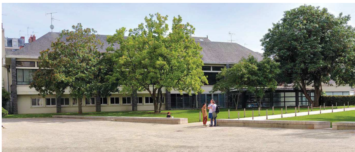
L'ancien restaurant universitaire de l'École des beaux-arts en travaux. Cliché réalisé en septembre 2019.
