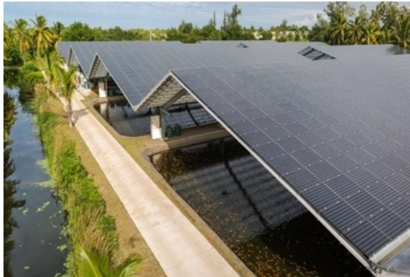
Illustration 23 Installation aquanergies® d'Akuo Energy sur l'exploitation des Cèdres, dans l'île de la Réunion (Source : Akuo Energy, https://www.akuoenergy.com/fr/aquanergie )
