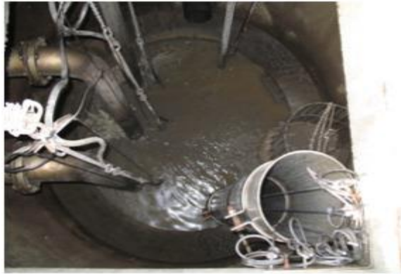
Figure 3 : Vue d'un poste de relevage
