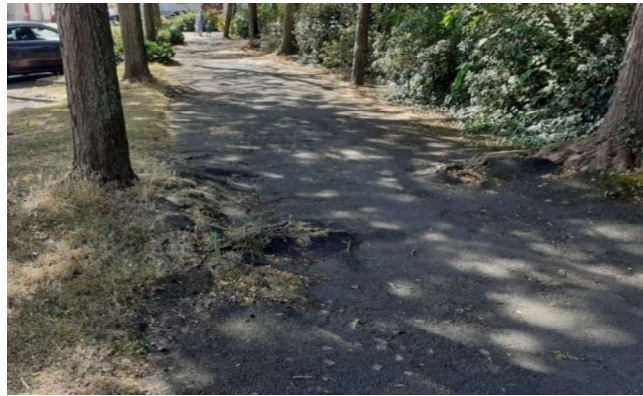
Figure 4 : Dégradation des chaussées par les racines de Robinia pseudoacacia autour de la place Verdun à Saumur (Ballan, 2021).
