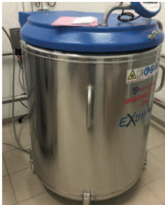
Figure 17 : Cuve d'azote en phase gazeuse(61)
