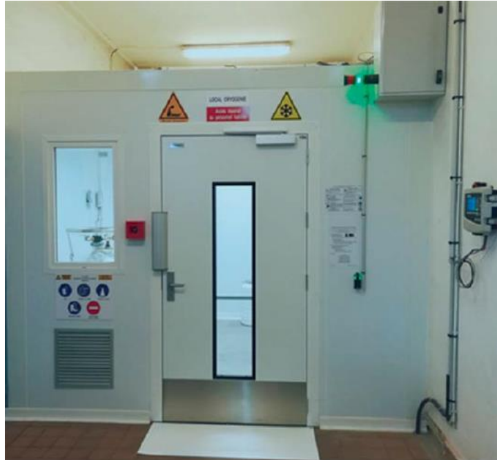
Figure 18 : Salle de cryogénie au sein d'une PUI (43)
